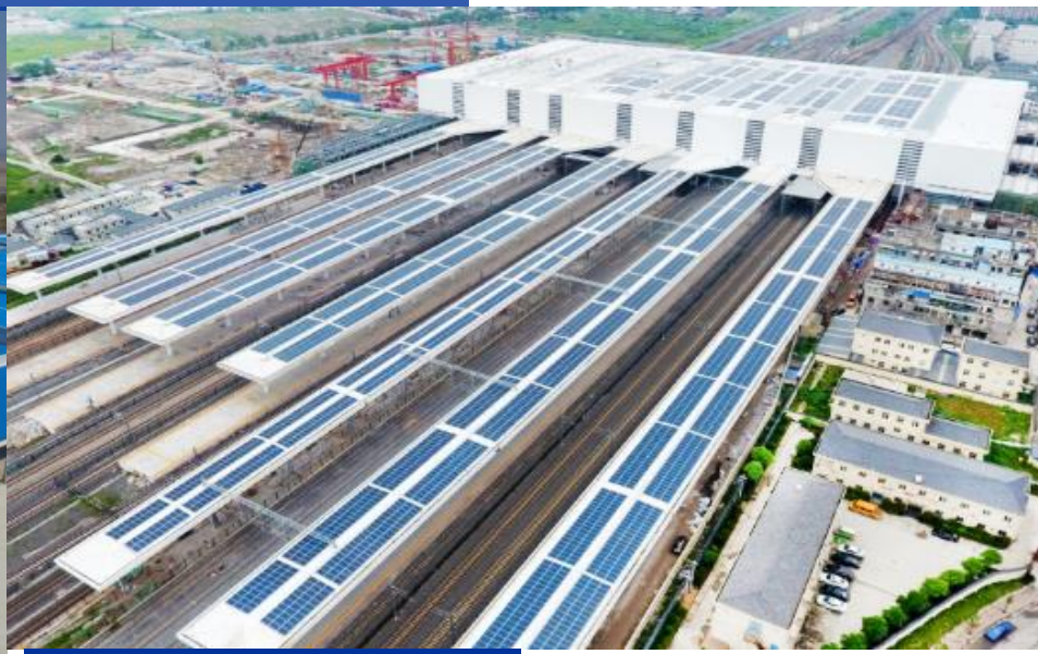
杭州火车南站 4.2MW屋顶光伏电站
