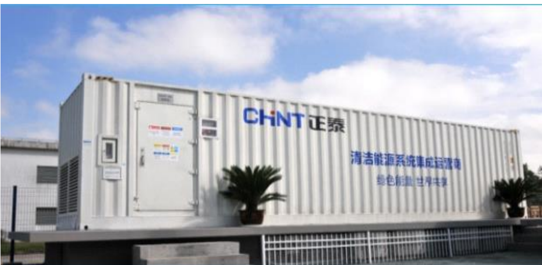
正泰上海产业园500KW/1MWh储能项目
